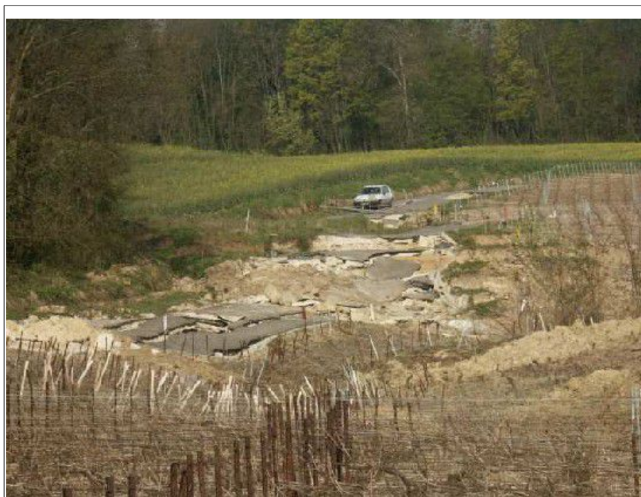
Illustration 4: dégâts occasionnés sur la route de Boursault à Vauciennes
